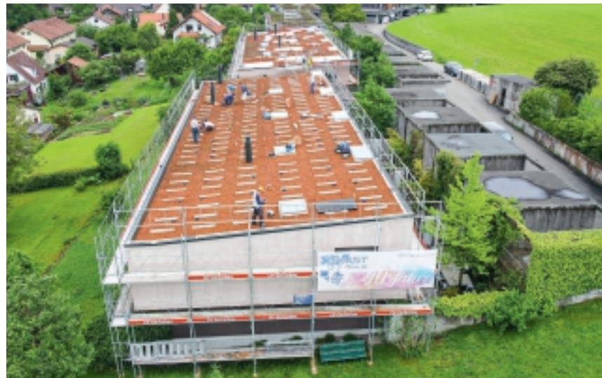
Blick aus der Vogelperspektive: Die «PV-Gemeinschaft Roos» im Einsatz auf dem Dach ihrer Gebäude
